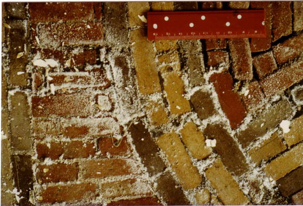
Abb.23: Salzausblühungen am Probenpunkt 5
